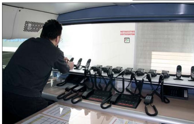
Funkarbeitsplatz: Im hinteren Teil des ELW 3 liegt der Funkraum mit vier Arbeitsplätzen.
